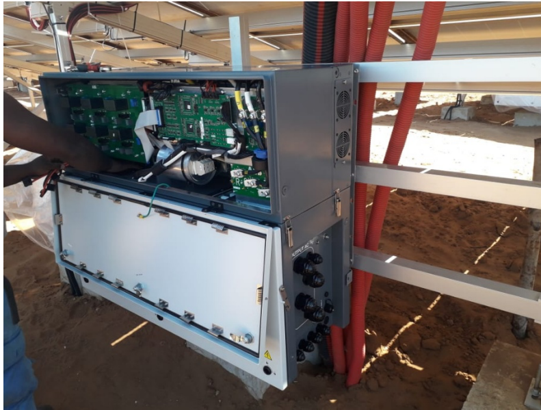
Figure 19- Onduleur de chaîne (string)
