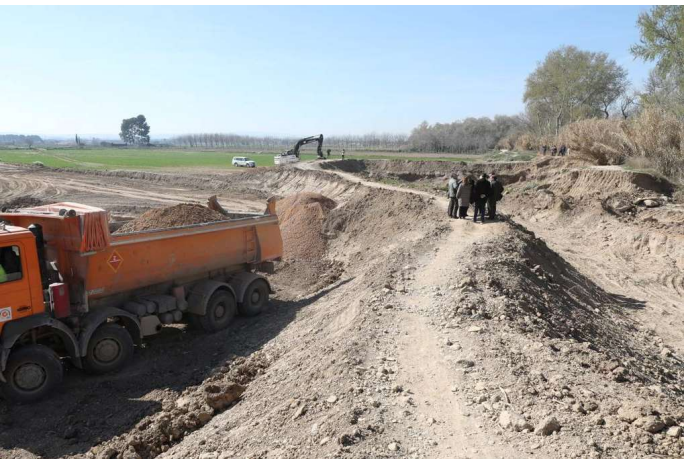
Trabajos de consolidación de la mota de protección en el río Ebro. Fuente: El Periódico de Aragón.
