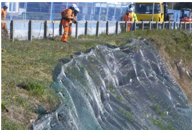
Tareas de estabilización en los Acantilados de Canford, Reino Unido . Fuente: BCP Council.
