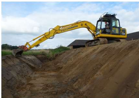
Trabajos para la construcción de una trampa de sedimento en Rother Valley, Reino Unido. Fuente: reefball.org.
