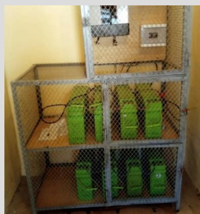
Photo 24 · Batteries de stockage de l'électricité Batterie de stockage d'énergie installée le 15 décembre 2022 à Pette, dans la première installation pilote
