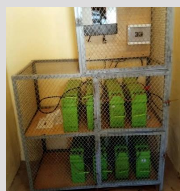
Photo 9 · Batteries de stockage de l'électricité Batterie de stockage d'énergie installée le 15 décembre 2022 à Petté, dans la première installation pilote
