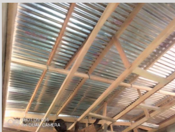
Photo 23 · Toiture refaite (pour supporter les panneaux solaires). Réfection de la toiture du Bâtiment temporaire de Pette pour bien supporter les panneaux solaires
