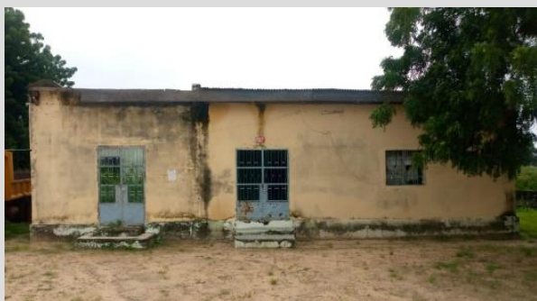
Photo 21 · Bâtiment prévu à Pette pour le stockage du lait, avant réfection et après réfection
