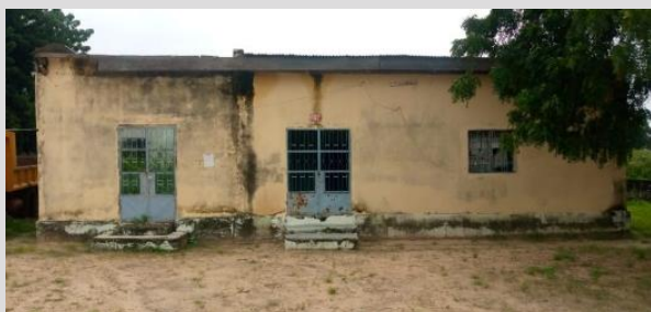
Photo 6 · Bâtiment prévu à Petté pour le stockage du lait, avant réfection et après réfection
