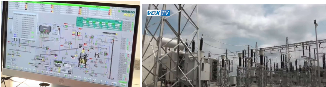
Figure 33 – (L) Système Siemens PCS 7 DCS (zone brute du broyeur illustrée), (R) Poste de commutation principal 2 transformateurs de 20 MW
