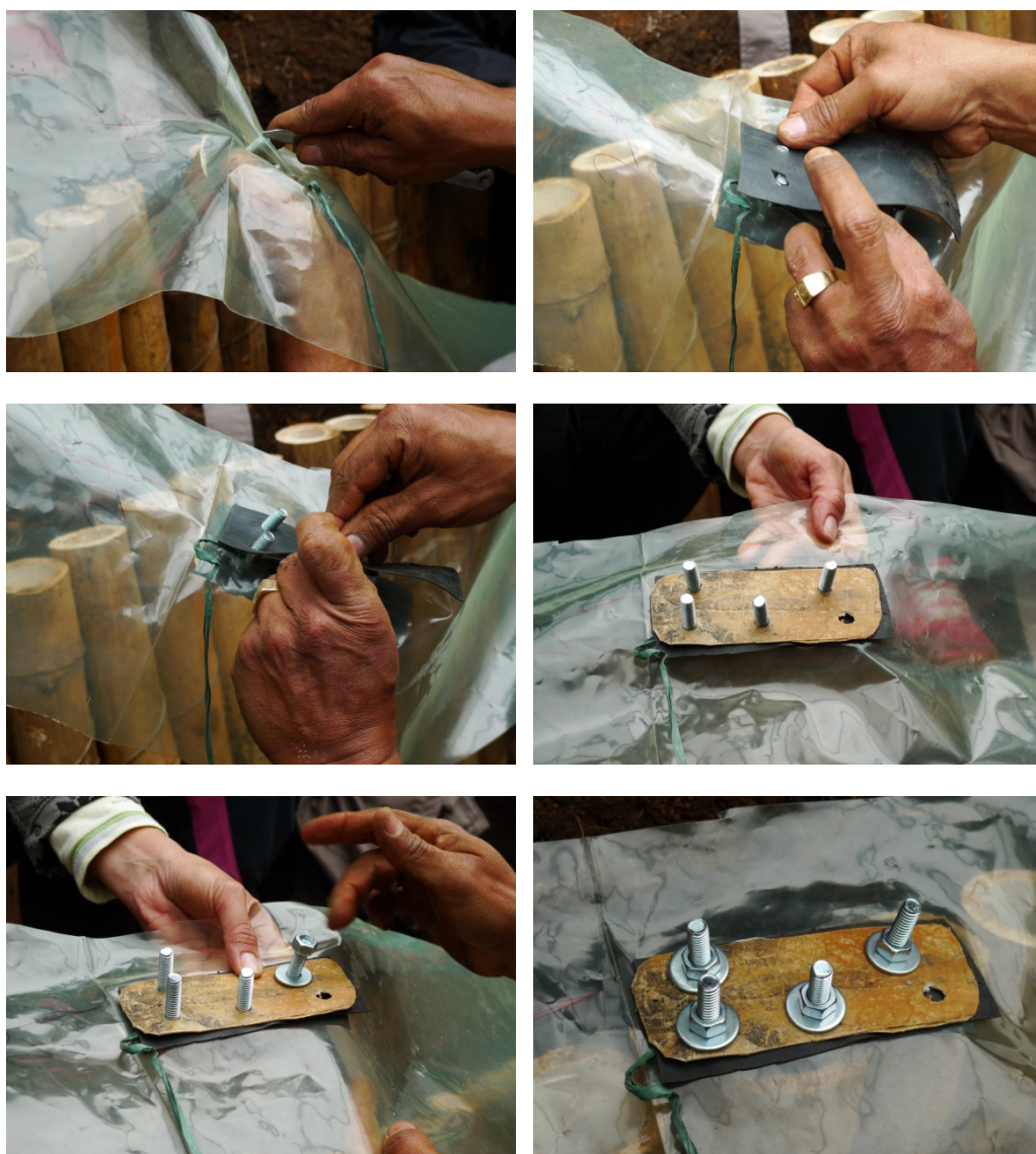
Figura 4: Secuencia fotográfica simulando la reparación “a la colombiana” de un hueco en un biodigester tubular de plástico de invernadero, usando dos láminas de PVC, dos empaques, tornillos y tuercas.
