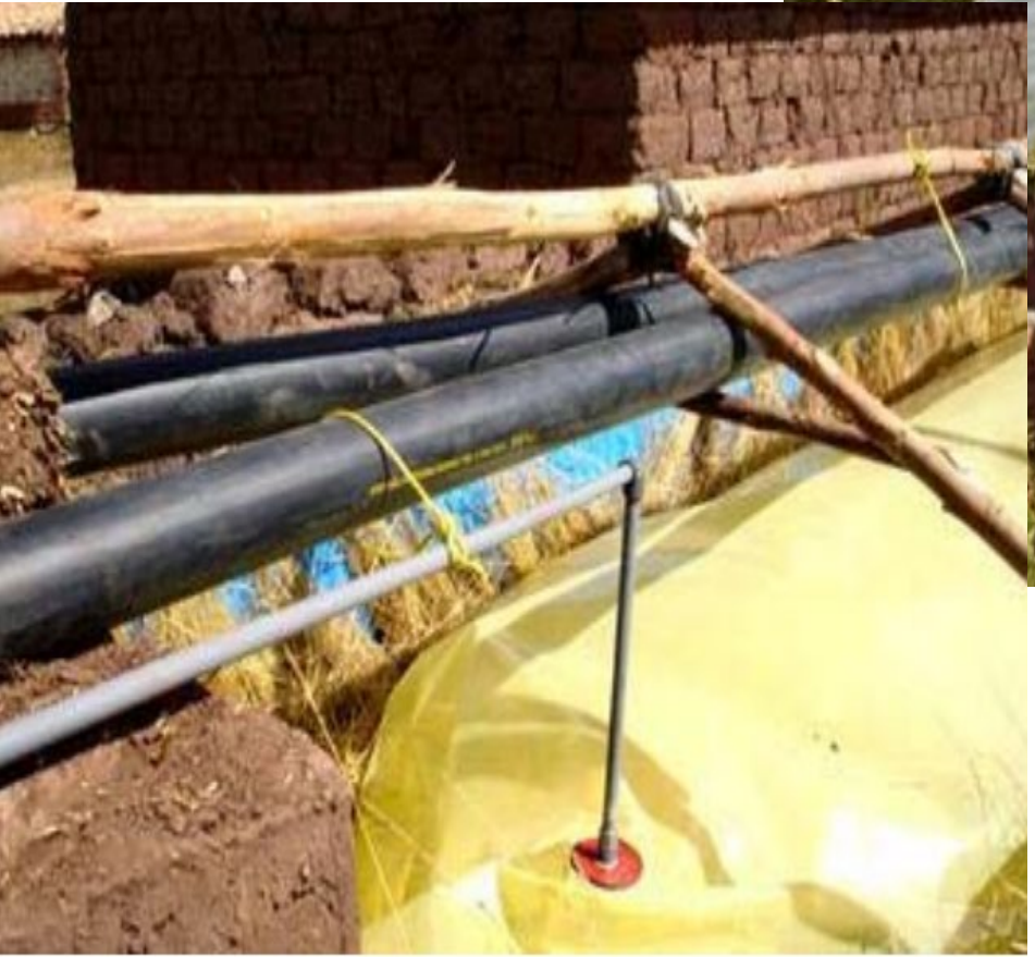
Figura 5. Tuberías para pre-calentar el agua de dilución
