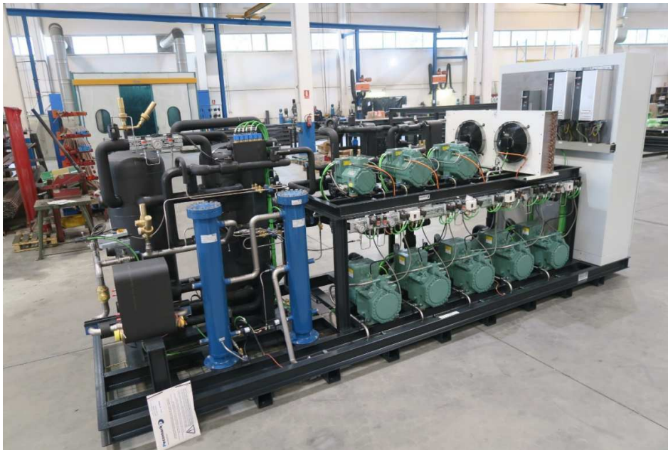
Foto 1: Central Booster Transcrítico para CO 2
